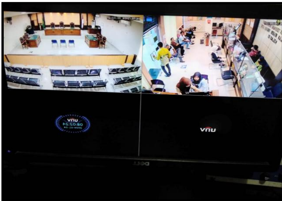
CCTV pada PTSP
